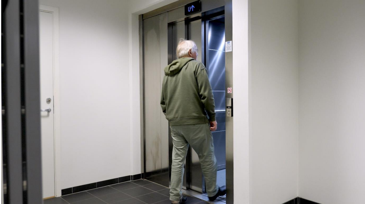
Heisen blir kontrollert av eksterne leverandører fire ganger i året.
