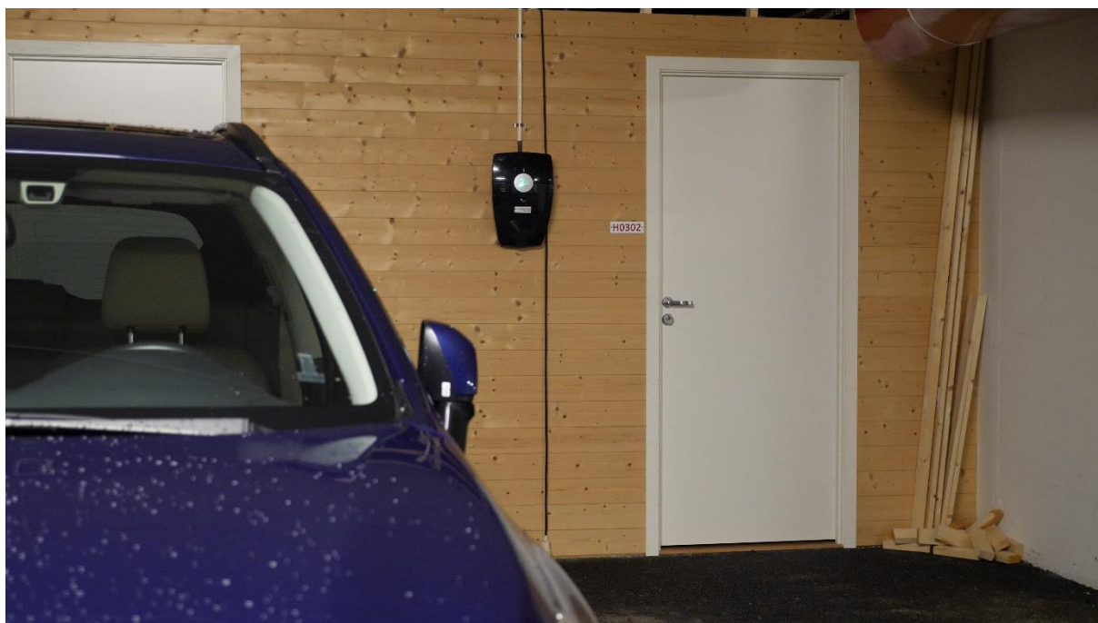
Det er lagt til rette for at beboerne kan installere ladesystem.
